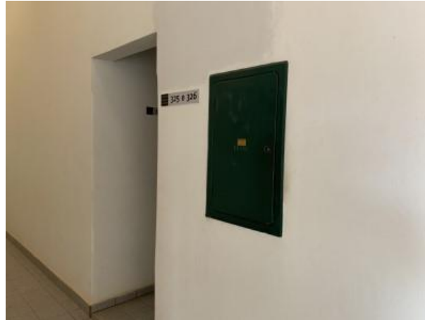
FOTO 34 LOCALIZAÇÃO PORTA FECHADA
