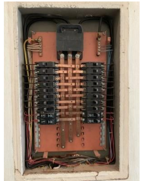
FOTO 24 PORTA ABERTA SEM PROTEÇÃO CONTRA CONTATOS DIRETOS
