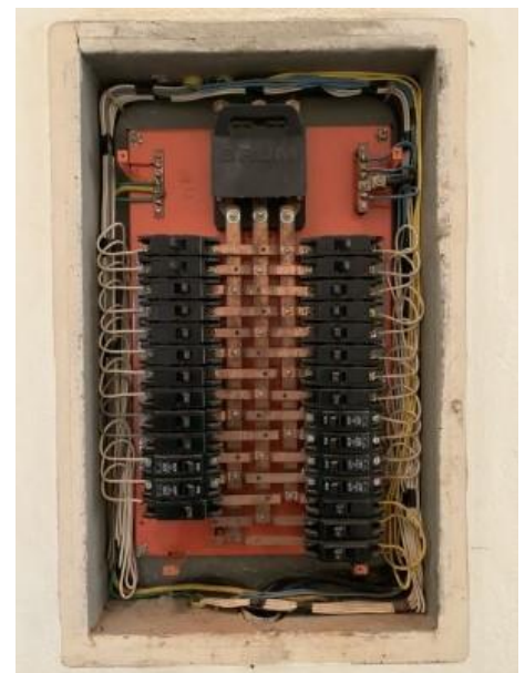
FOTO 15 PORTA ABERTA SEM PROTEÇÃO CONTRA CONTATOS DIRETOS
