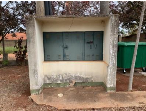
FOTO 3 ABRIGO DA MEDIÇÃO B.T. PORTAS FECHADAS
