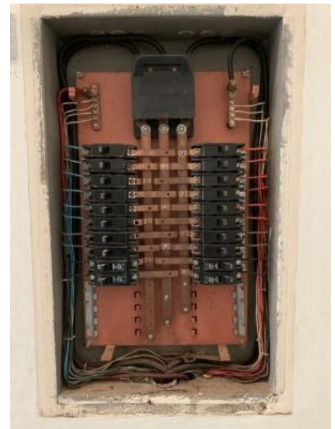
FOTO 33 PORTA ABERTA SEM PROTEÇÃO CONTRA CONTATOS DIRETOS
