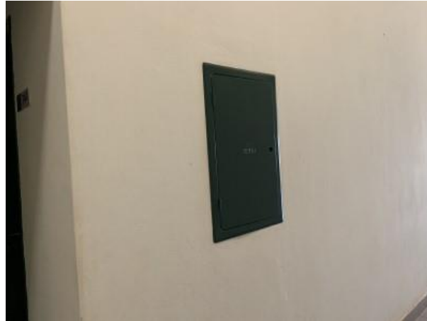
FOTO 37 LOCALIZAÇÃO PORTA FECHADA
