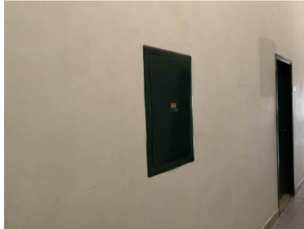
FOTO 28 LOCALIZAÇÃO PORTA FECHADA
