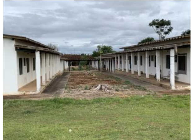
FOTO 57 VISTA ENTRE BLOCOS 3 E 2 RESPECTIVAMENTE
