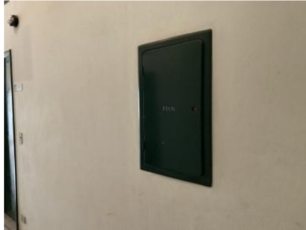
FOTO 19 LOCALIZAÇÃO PORTA FECHADA
