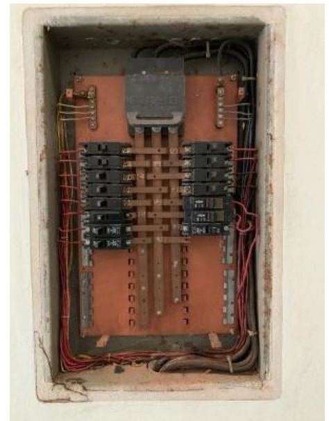
FOTO 21 PORTA ABERTA SEM PROTEÇÃO CONTRA CONTATOS DIRETOS
