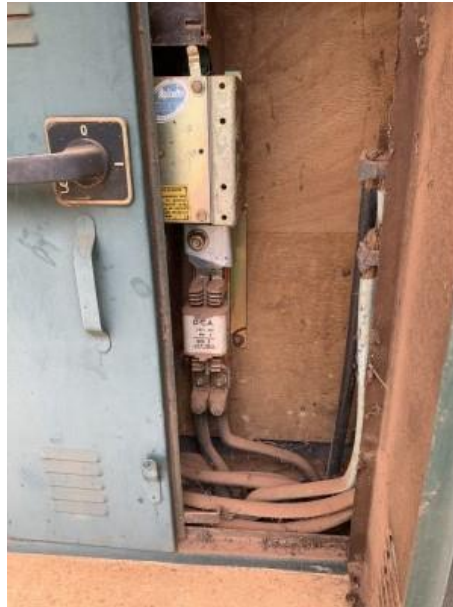
FOTO 5 CAIXA "T" PORTAS ABERTAS
