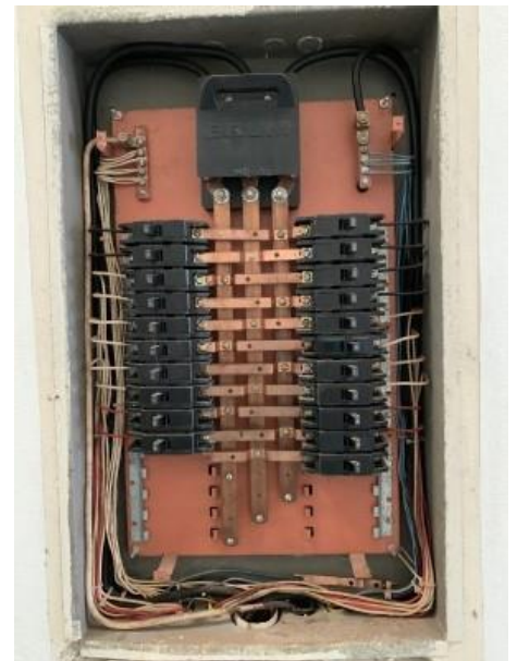
FOTO 39 PORTA ABERTA SEM PROTEÇÃO CONTRA CONTATOS DIRETOS
