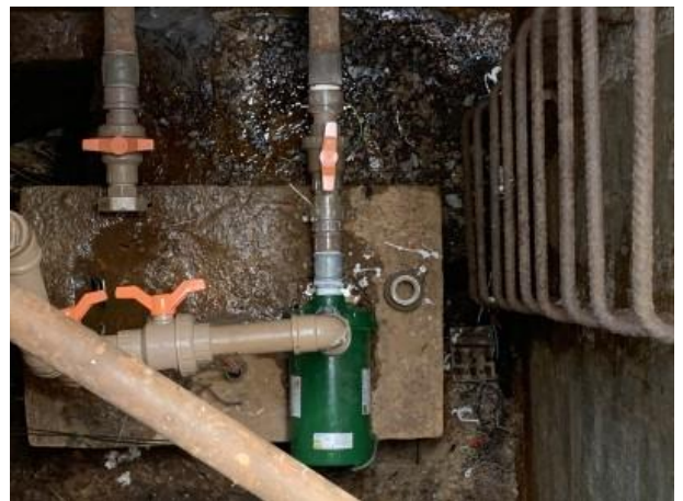
FOTO 63 BOMBA DO RESERVATÓRIO ENTERRADO
