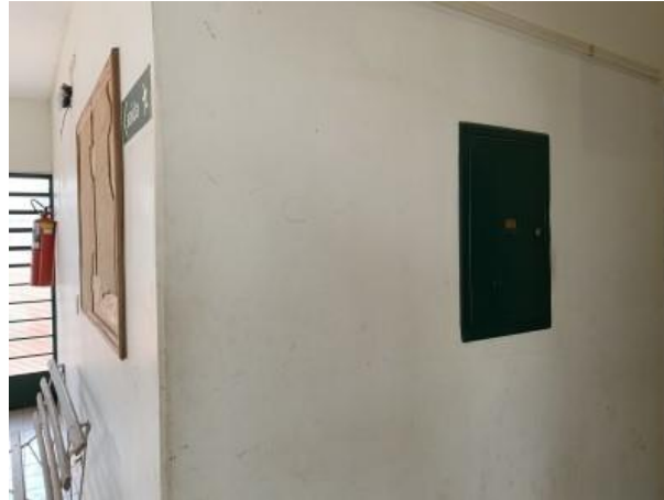
FOTO 25 LOCALIZAÇÃO PORTA FECHADA
