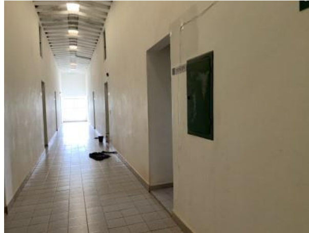
FOTO 31 LOCALIZAÇÃO PORTA FECHADA
