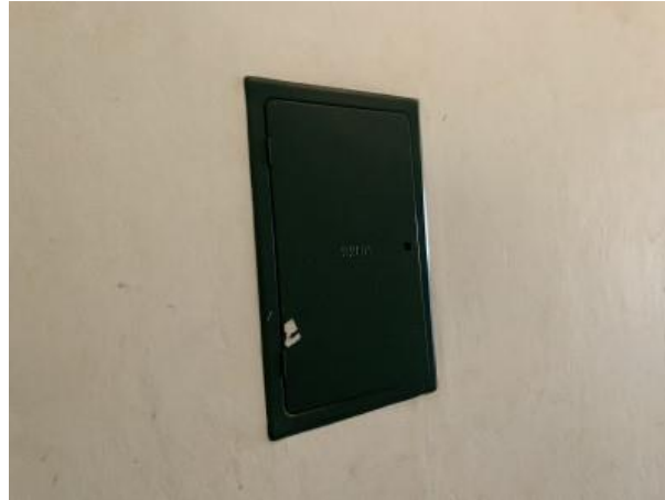
FOTO 22 LOCALIZAÇÃO PORTA FECHADA
