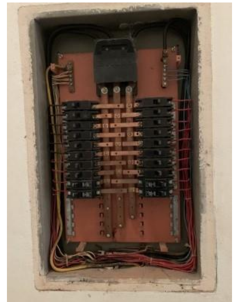
FOTO 30 PORTA ABERTA SEM PROTEÇÃO CONTRA CONTATOS DIRETOS
